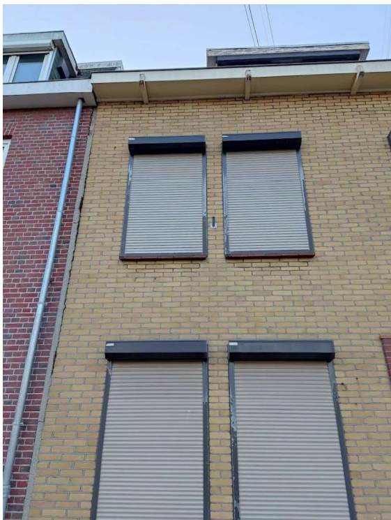
Figuur 3.1 Rolluiken en daklijst met kieren bij nummer 9.
