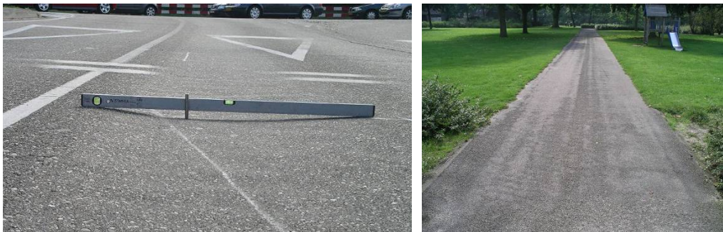
Figuur bijlage 1-1 Schades dwarsonvlakheid en rafeling
